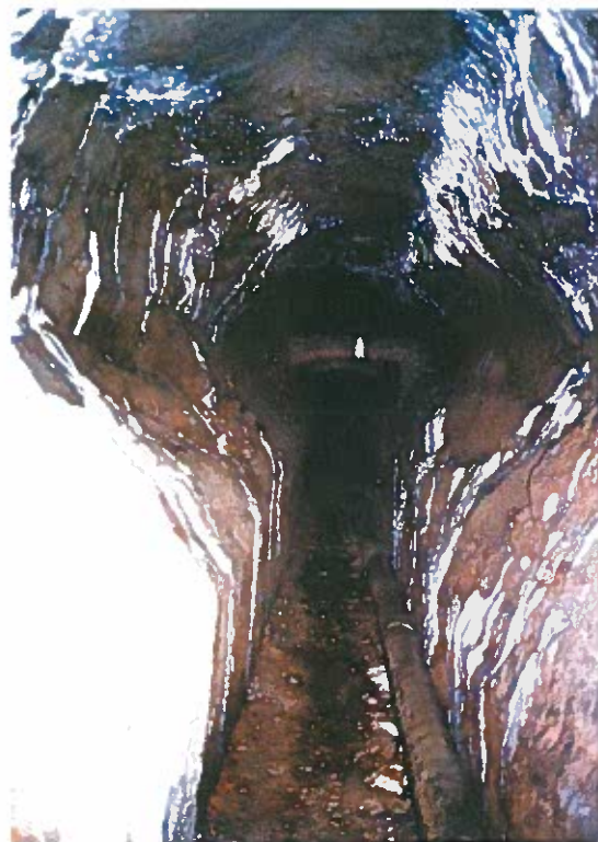
Foto 4.14: in prossimità del I bypass numerose colate calcistiche indicano la presenza di infiltrazioni di acqua. Si noti sullo sfondo uno degli archi di contenimento posti in opera nel 1928 per consolidare la struttura del condotto (foto V. Castellani).
